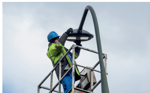
Montaż opraw SAVA na latarni miejskiej FOT. Zarząd Dróg Miejskich
